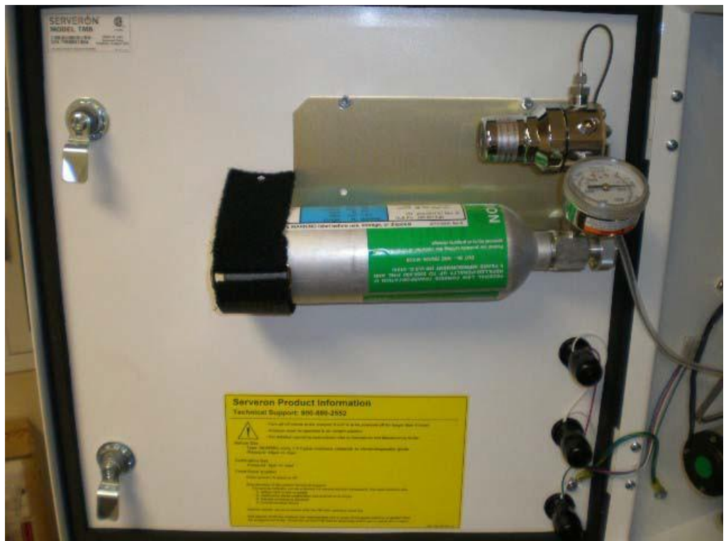
Figura 21: Cilindro de gas de calibración instalado
